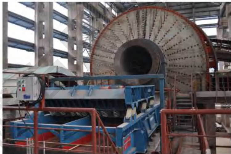
云南省昆钢大红山铁矿800万吨/年选厂现场。一台GK的STM-S3073与一台直径8.8米的半自磨机闭路筛分。原矿石处理量为1065吨/小时，聚氨酯筛网筛隙为8mm。
