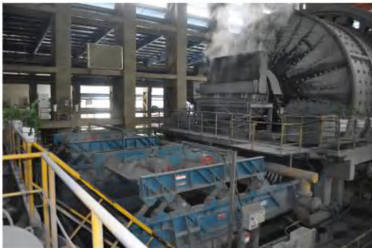
云南省昆钢大红山铁矿400万吨/年选厂现场。两台GK的STM-S3061与一台直径8.53米的半自磨机闭路筛分。一用一备，聚氨酯筛网筛隙为8mm。
