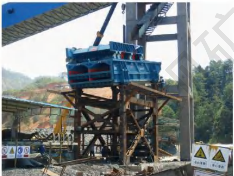
四川省安宁铁钛铁矿选场现场。两台GK的STM-D3073与高压对辊磨机闭路筛分。
