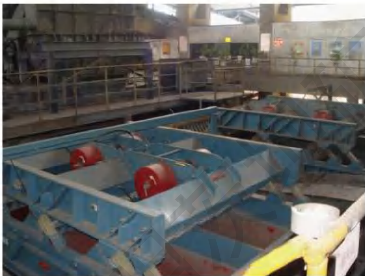
云南省昆钢大红山铁矿400万吨/年选厂现场。两台GK的STM-S3061与一台直径8.53米的半自磨机闭路筛分。一用一备，聚氨酯筛网筛隙为8mm。
