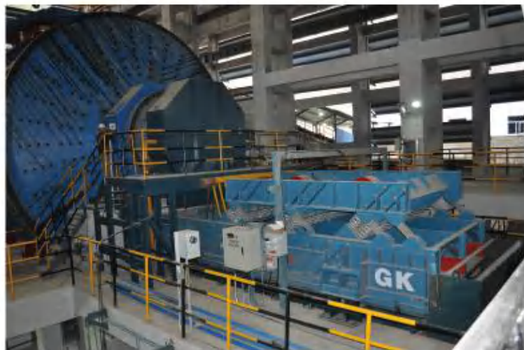
云南省昆钢大红山铁矿800万吨/年选厂现场。一台GK的STM-S2461与一台直径8米的半自磨机闭路筛分。原矿石处理量为580吨/小时，聚氨酯筛网筛隙为8mm。
